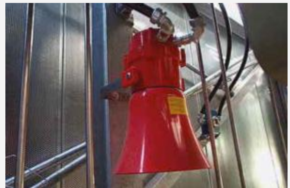
Akustischer Alarm in einem Gaskraftwerk: ☞-Schallgeber BExS 120 ATEX.
